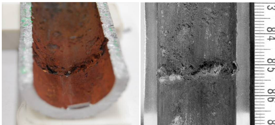
硫酸イオンによる給水ノズルの腐食
